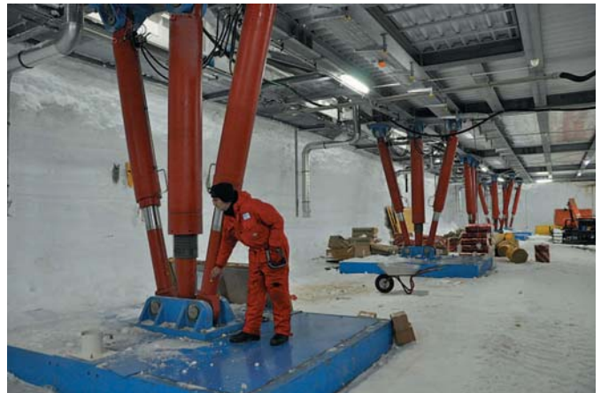
Abb. 3: In der Garage befinden sich die 16 Stützen, die als Bipoden mit je zwei Hydraulikzylindern ausgebildet sind. Das flexible Tragsystem gleicht Fundamentsetzungen aus, leitet horizontale Lasten in den Schneegrund ab und einmal im Jahr wird damit das Bauwerk als Ganzes angehoben. Anschließend werden die Fundamentplatten nacheinander angehoben und mit Schnee unterfüllt (Foto: U. Cieluch, AWI).
